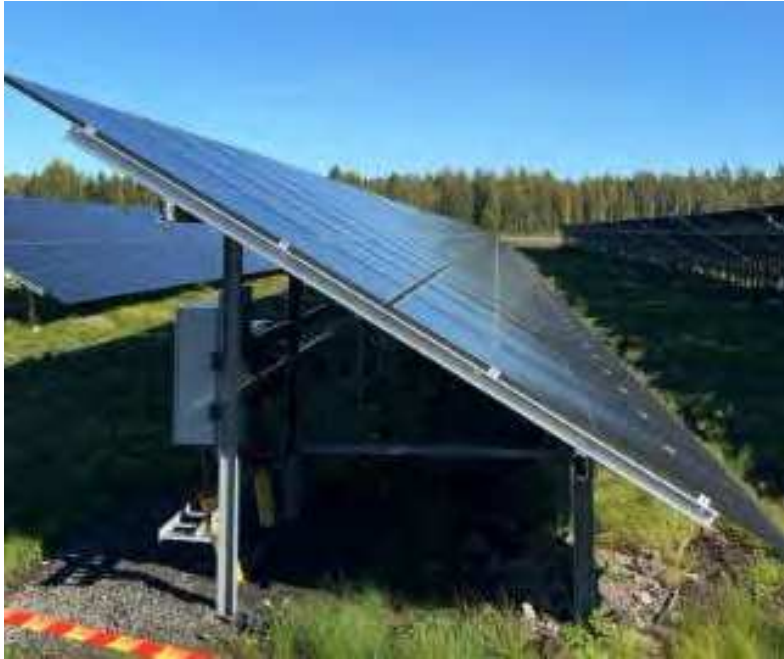
Kuva 8. Omien perustusten varaan asennettuja aurinkopaneeleita (Sitema Oy)
